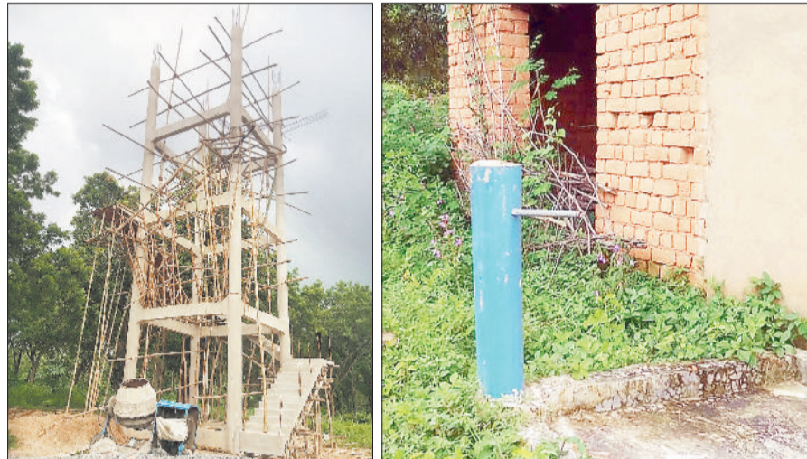
जलजीवन मिशन के तहत ग्रामीण क्षेत्रों में चल रहा टंकी निर्माण और लगाए गए टैप नल जिससे नहीं निकल रहा पानी।
